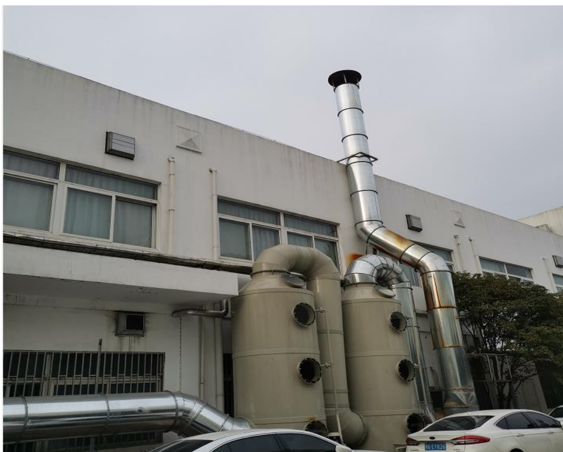
图 4-1 A 区温浸全汁收稠异味处理装置现状图
