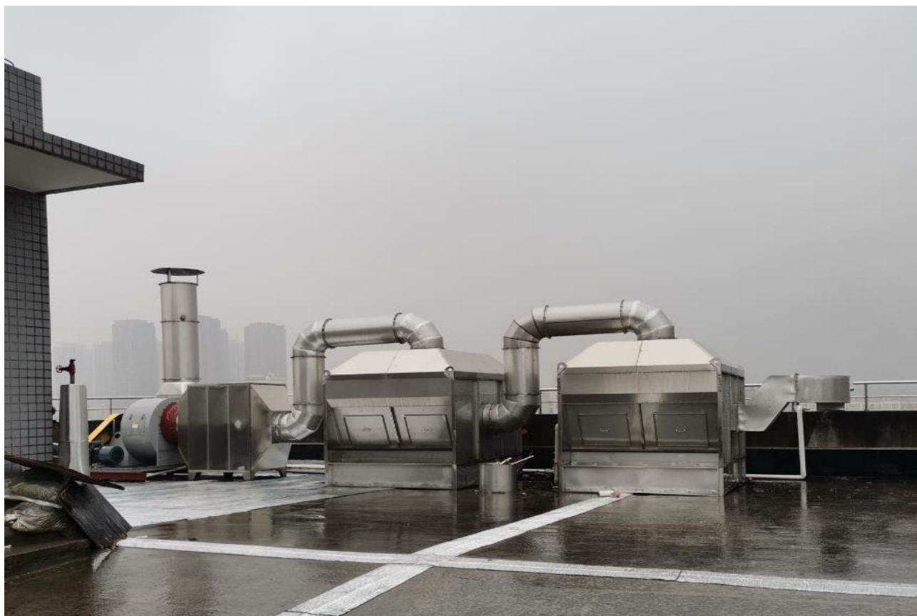
图 4-2 B 区温浸全汁收稠异味处理装置现状图
